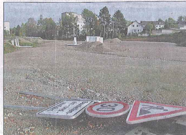
Die Baustellenschilder werden bald wieder ihren Platz einnehmen: Am Börkey kann nach der Entscheidung des Verwaltungsgerichtes Arnsberg die Errichtung des Edeka-Marktes weitergehen. (Foto: Frank Schmidt)
